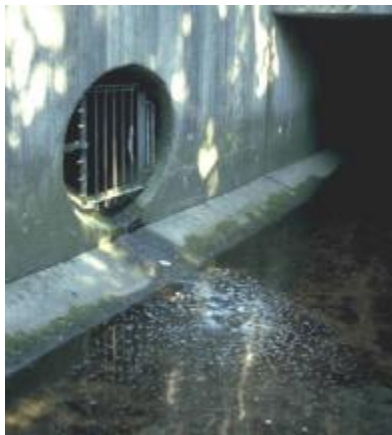
Bild 9: Ausgeschüttetes Putzwasser hat in Niedrigwassersituationen unmittelbare Schädigung. – Der Durchmesser des Zulaufs lässt die hydraulische Situation beim Starkregeneignis erahnen.
