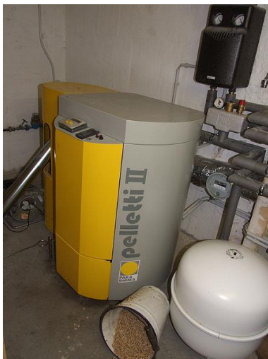
Abbildung 7: Pelletkessel in Wohnhaus; via https://commons.wikimedia.org/wiki/File:Pelletkessel_in_Wohnhaus.JPG
