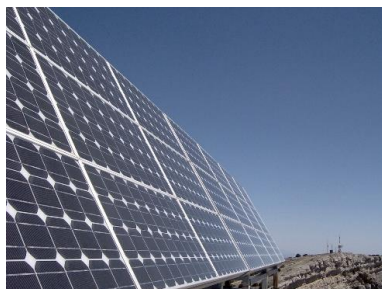
Abbildung 6: Photovoltaikanlage, von Fernando Tomás aus Zaragoza, Spain - Flickr, CC BY 2.0, https://commons.wikimedia.org/w/index.php?curid=779211
