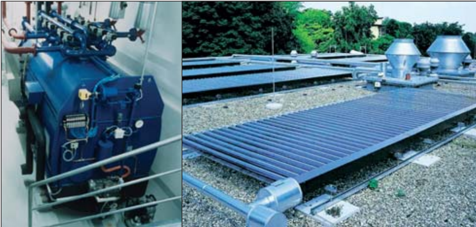
Abb. 7 Am Universitätsklinikum Freiburg wurde ein Kollektorfeld mit 170 m 2 Vakuumröhrenkollektoren mit einer Adsorptionskältemaschine im Rahmen eines Forschungsprojekts installiert. [Quelle: FhG ISE]
