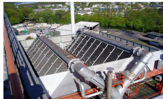
Luftkondensatoren mit neuen frequenzgeregelten Lüfterantrieben
