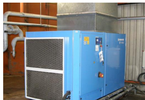
Frequenzgeregelter Verdichter zur Druckluftzeugung mit 75 kW
