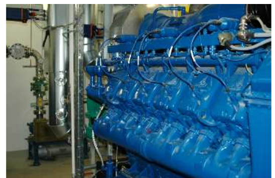
Blockheizkraftwerksmotor mit einer elektrischen Leistung von ca. 1.000 kW.
