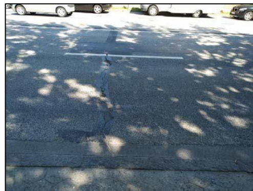
Abbildung 5: schlechter Fahrbahnzustand Steilshooper Straße (Wandsbek) (Quelle: IVAS)
