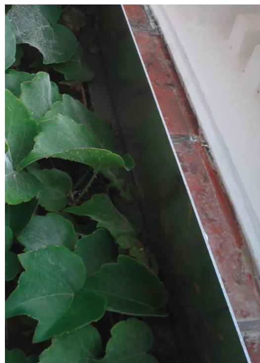
Abbildung 10: vertikale Brandsperre (Foto: © GG Green, Peter Boogaerts)
