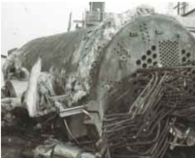
Explodierter Kessel – Prüffrist überschritten?
