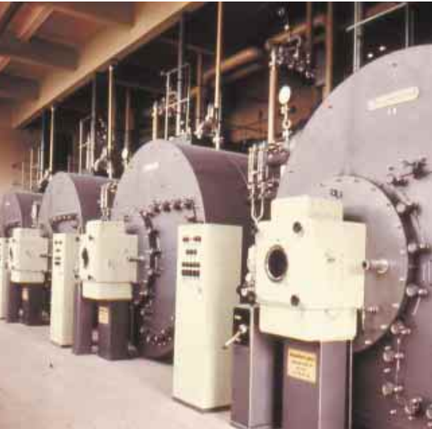
Steht unter Druck – die Dampfkesselanlage
